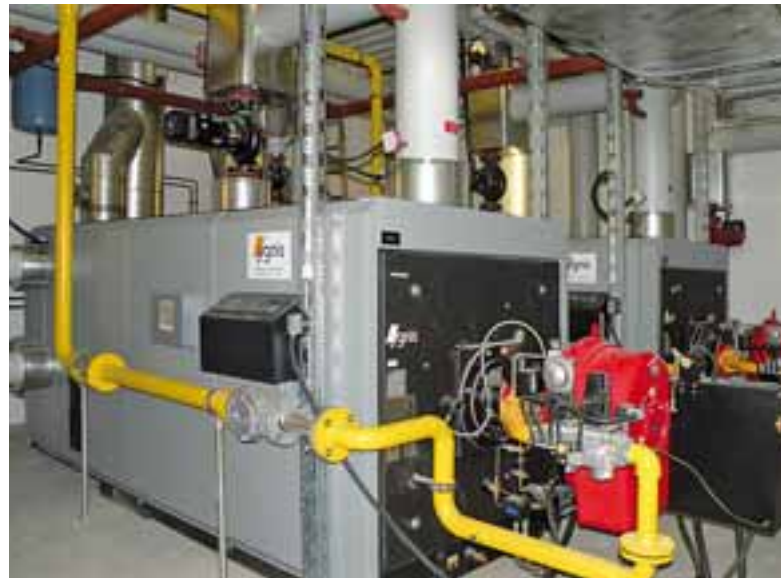
Heizkessel mit Kondensationsrekuperator und Gas-Öl-Zweistoffbrennern
