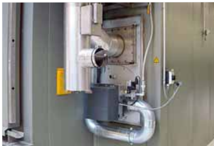
Der 250 kW-Gas-Gebläsebrenner des Trocknungsovens
