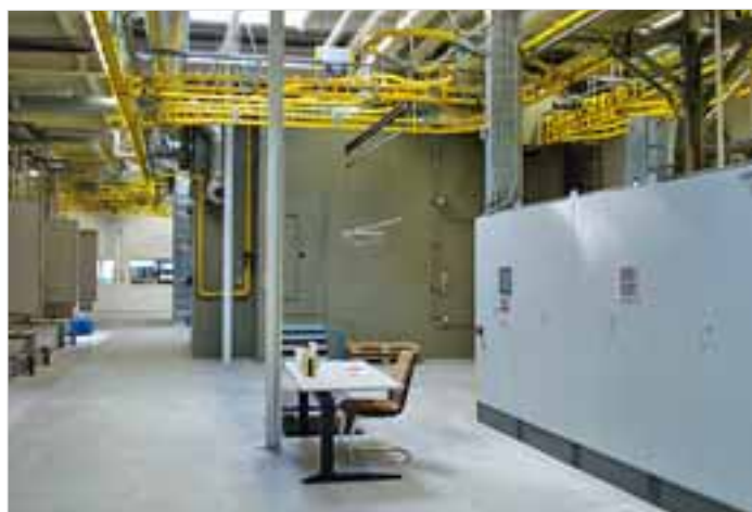
Blick auf den Durchlauf-Trocknungsoven
