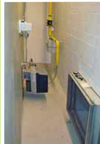
Der 290 kW-Gas-Gebläsebrenner des Einbrennofens
